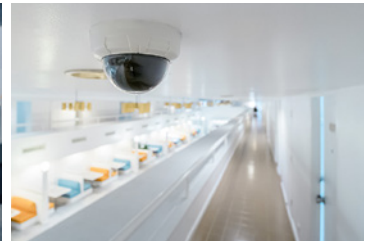
闭路电视 (CCTV)
